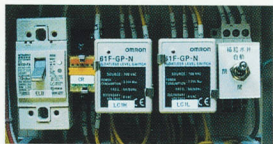
制御盤の内部
